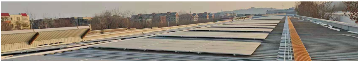
龙背村停车场分布式光伏试点项目
