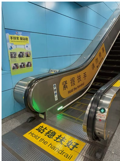
电扶梯安全提示
