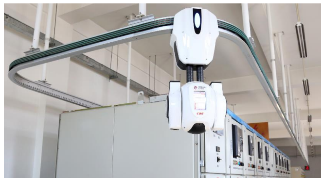
智能巡检机器人
